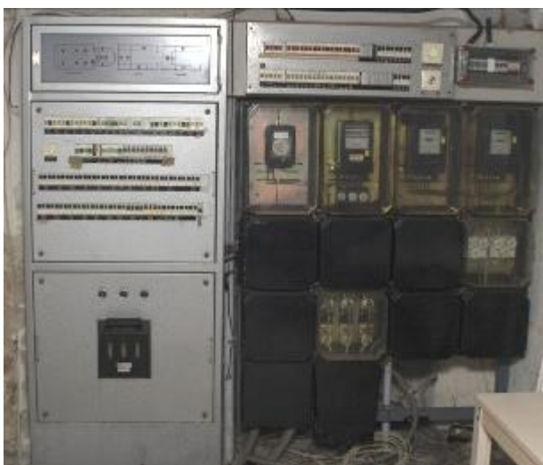
Völlig veraltet und verbraucht war die längst in die Jahre gekommene Elektroinstallation in der Sakristei.
