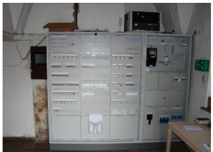
Die neue Elektroanlage wird noch einen Schrank bekommen, damit der Charakter der Sakristei als Vorbereitungsraum für den Gottesdienst gewahrt bleibt.
